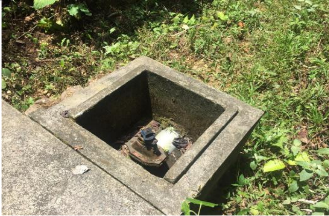
Fuente: Ficha Técnica Estándar, 2024 (Sistema existente que presenta deterioro en las estructuras)
