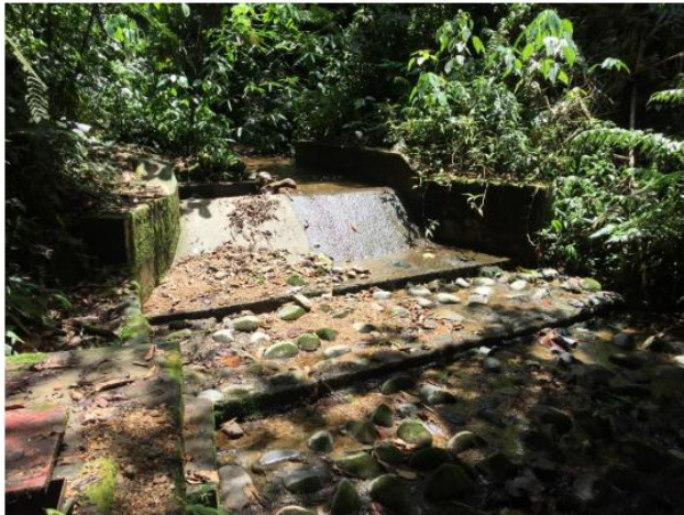
Fotografía 1: SISTEMA DE CAPTACION
