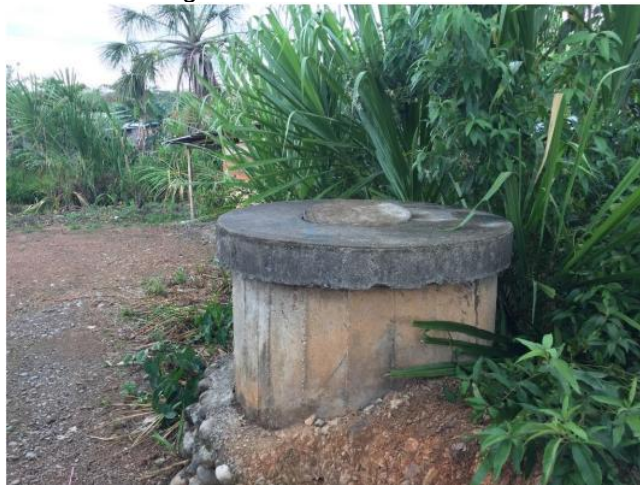
Fuente: Ficha Técnica Estándar, 2024 (Sistema existente de red colectora, con tuberías de alcantarillado y buzones)
